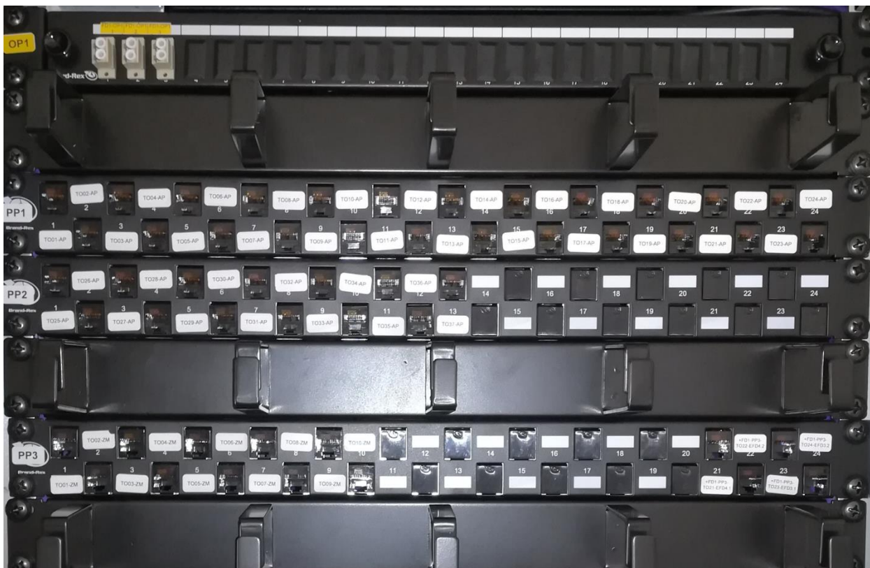
Slika 9: Primjer označavanja razdjelnika i panela
